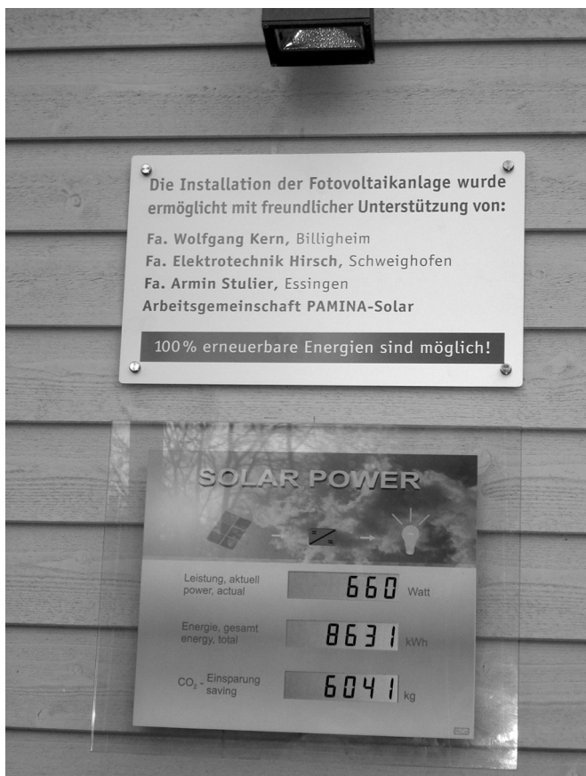
Fotovoltaikanlage auf Dach der Zooschule. Foto: J.-O. Heckel
